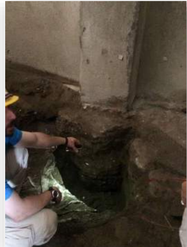
criticità in fondazione
