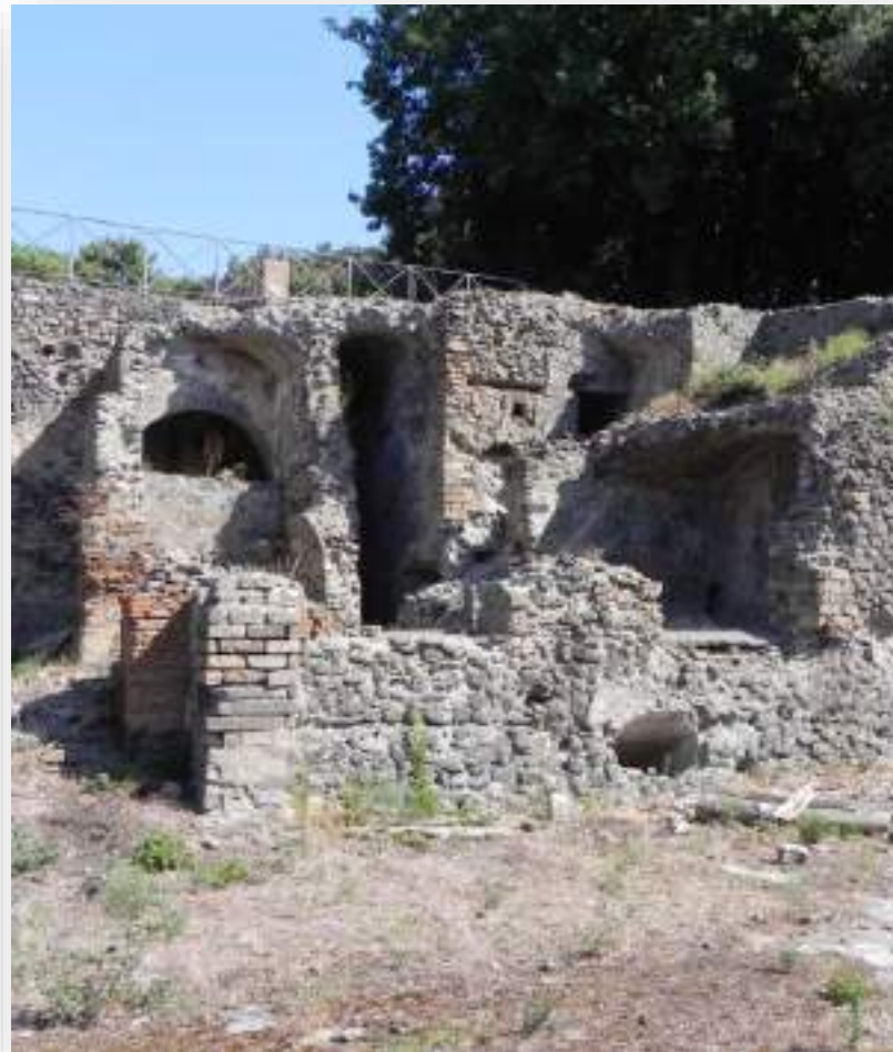
archi e volte dissestati
